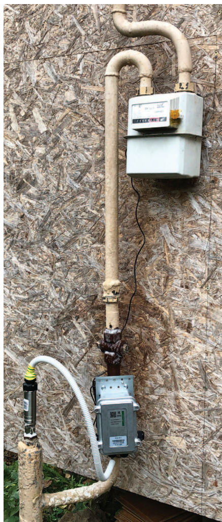
Рис. 5. Узел контроля PROMODEM на тупике газораспределения
